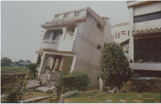
921地震土壤液化引致之建物傾斜
