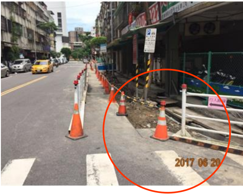
改善前：未放置道路方向指引
