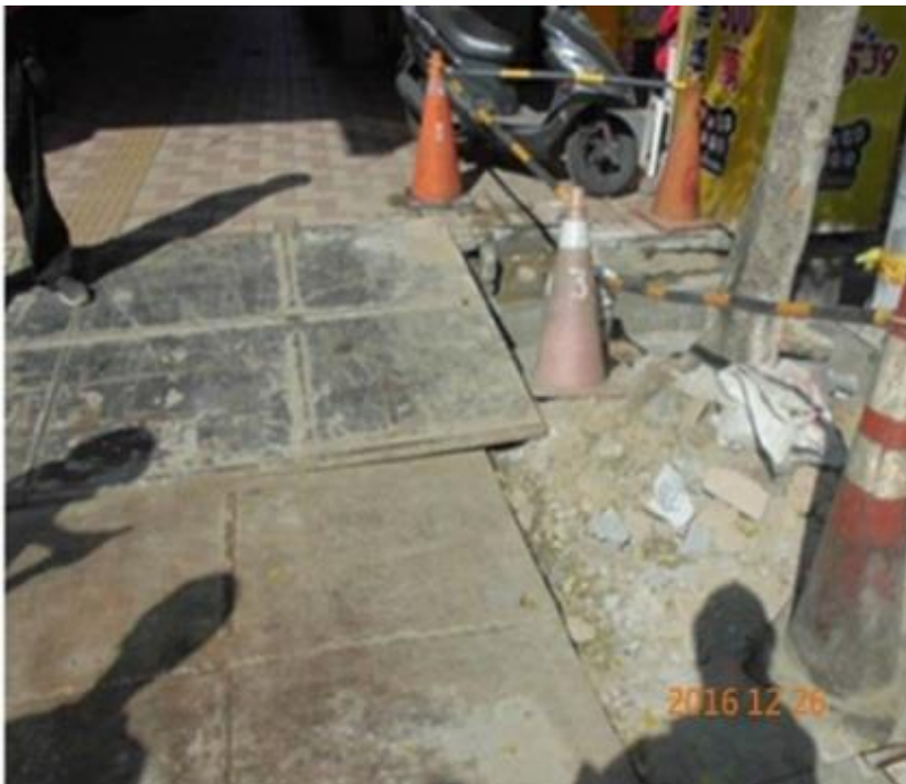
改善前:未區隔工區與人行動線
