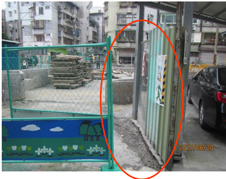
改善前：工區圍籬有缺口
