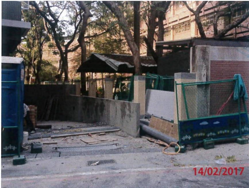
改善前：工區圍籬有缺口
