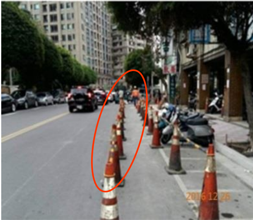
改善前：臨道路側未使用護欄
