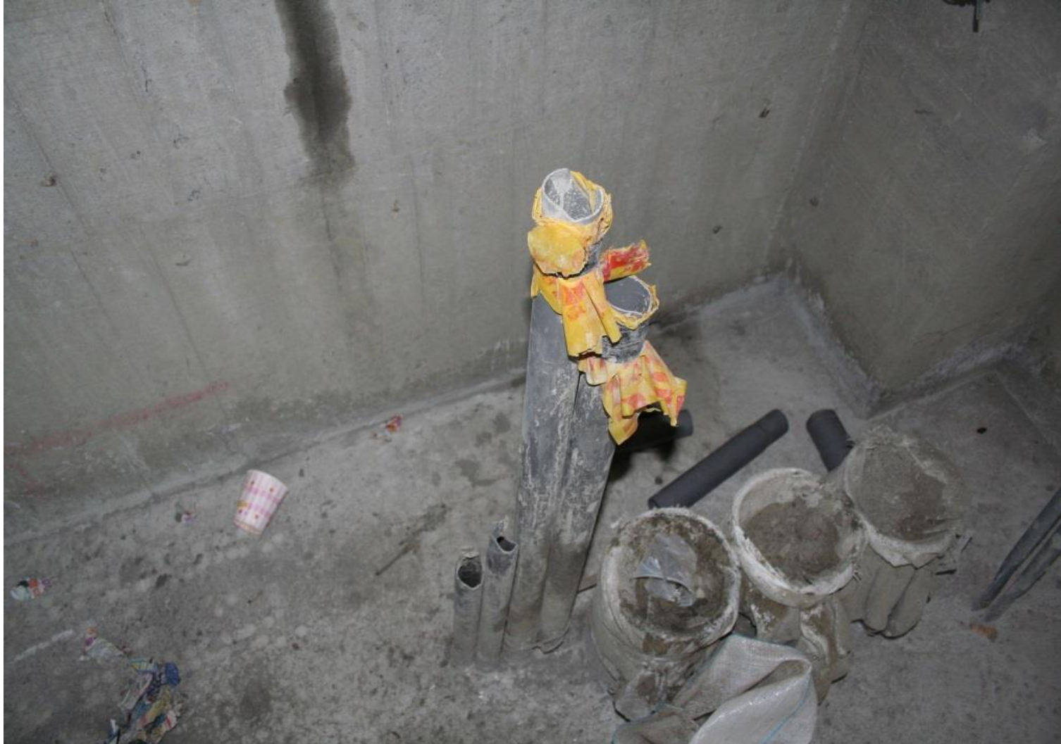
圖116工程會扣點編號5070510 說明：PVC管管路出口未防護
