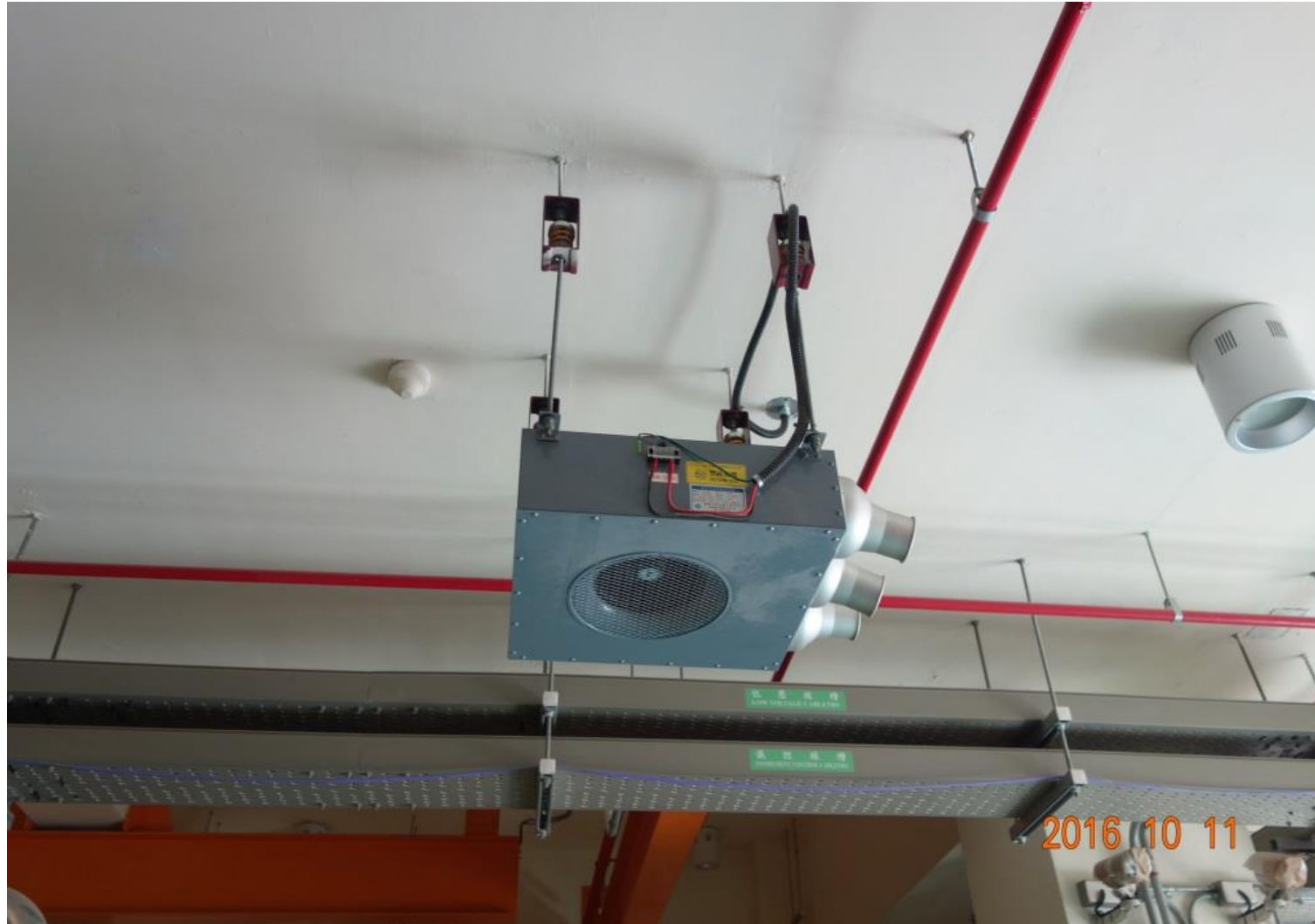
圖115工程會扣點編號5070499 說明：風機電源出口未防護
