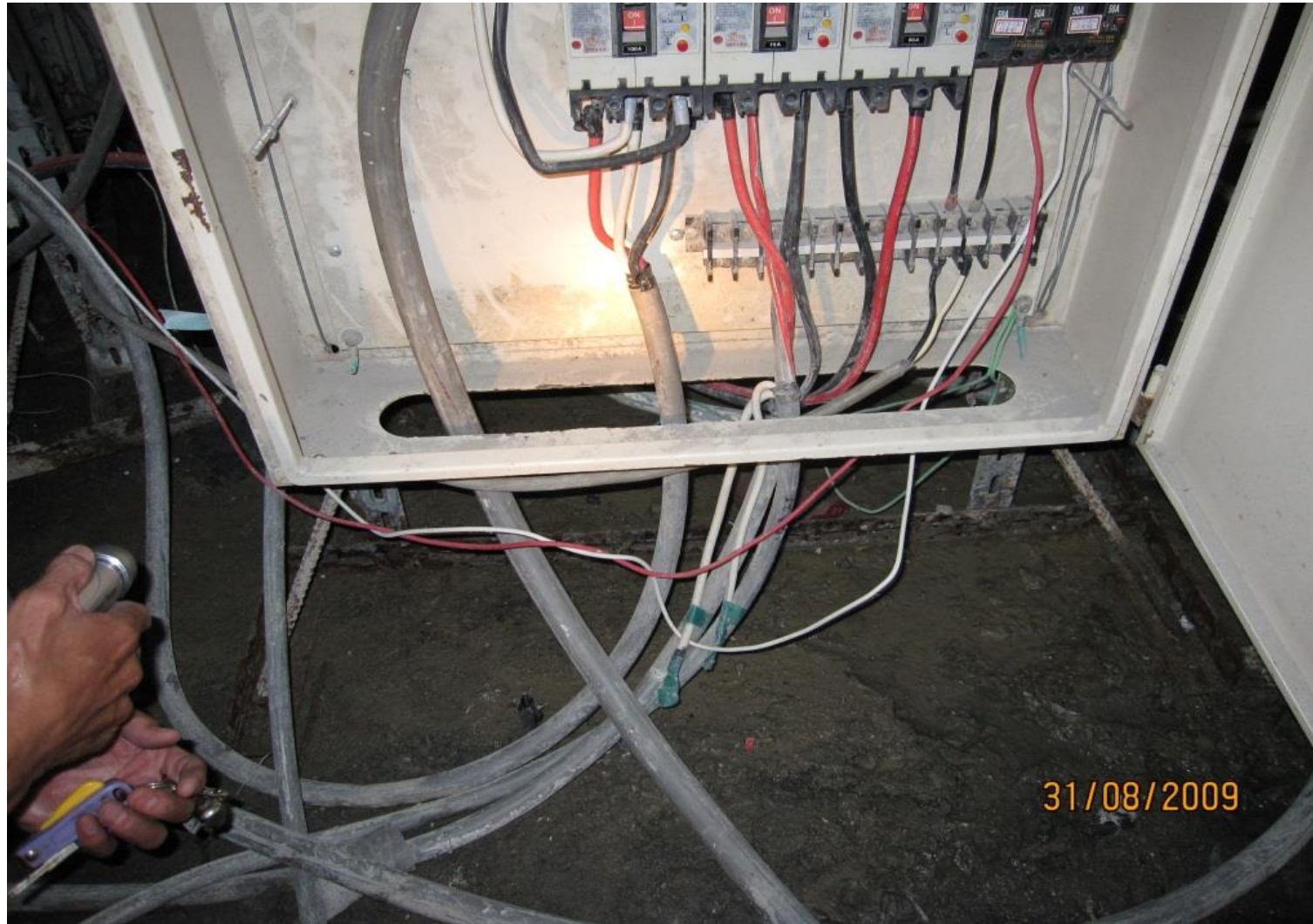
圖138工程會扣點編號5140301 說明：臨時電線未防護，影响用電安全
