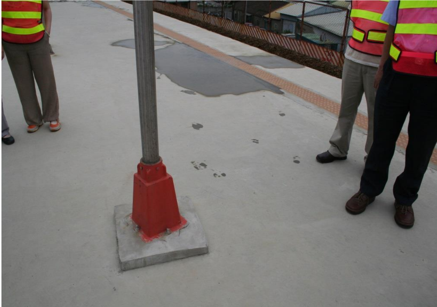
圖114工程會扣點編號5070499 說明：路燈基礎設置不當
