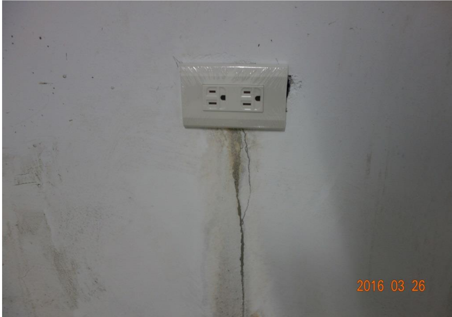
圖136工程會扣點編號5080908 說明：插座漏水，影响用電安全
