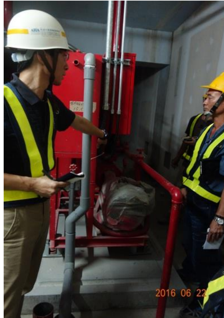
圖93工程會扣點編號5070412 說明：管路與震動設備之間未使用軟管連接
