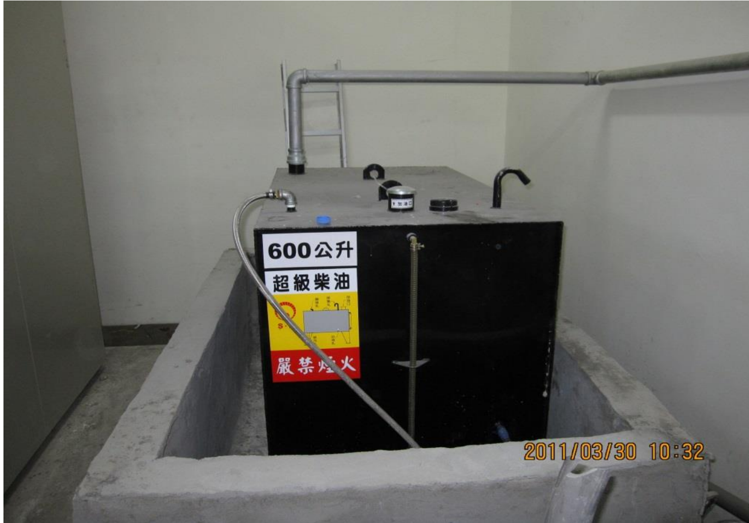
圖104工程會扣點編號5070426 說明：日用油箱透氣管未配至戶外
