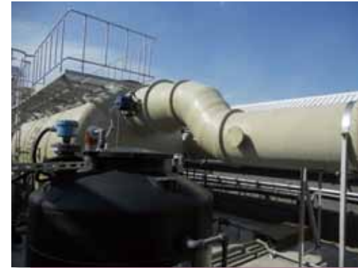
» 再生型除煙（臭）設備
