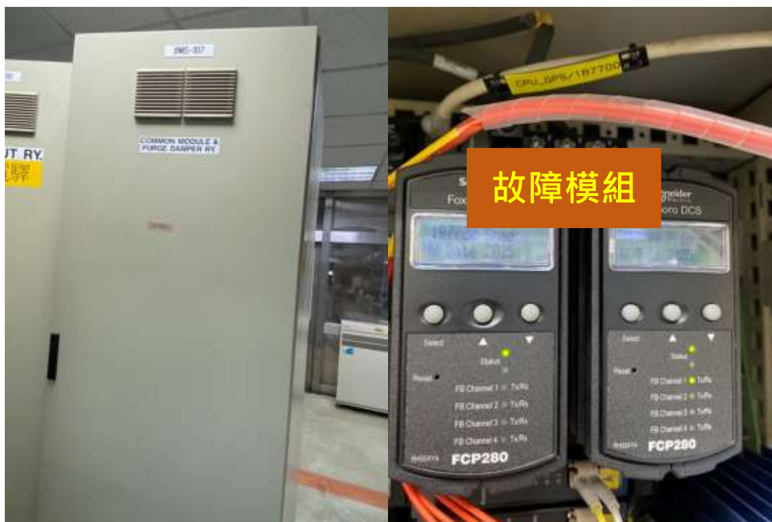
圖 2-6 現場控制箱盤照片
