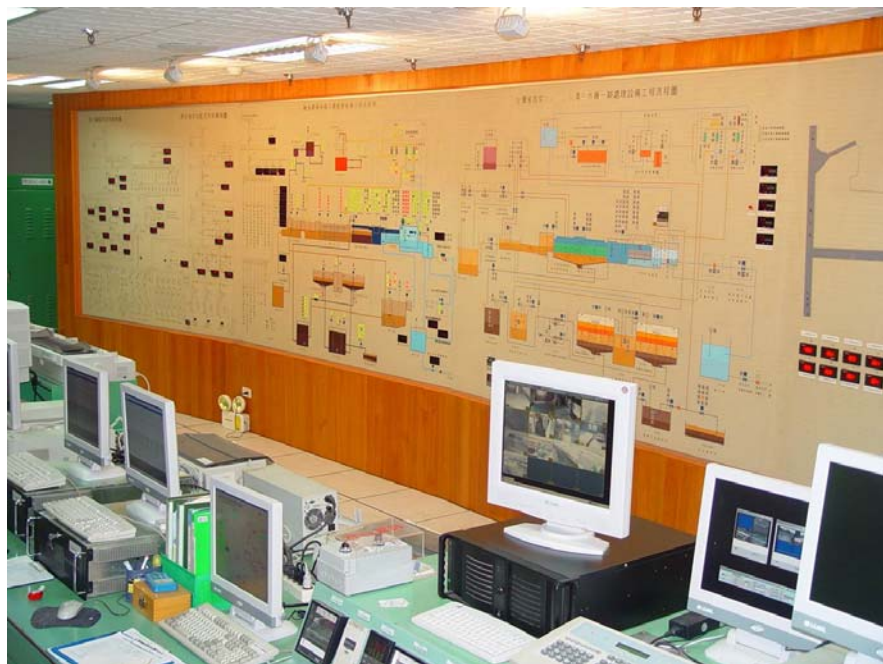
■ 給水廠電腦監控
