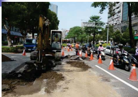
交通號誌線路
