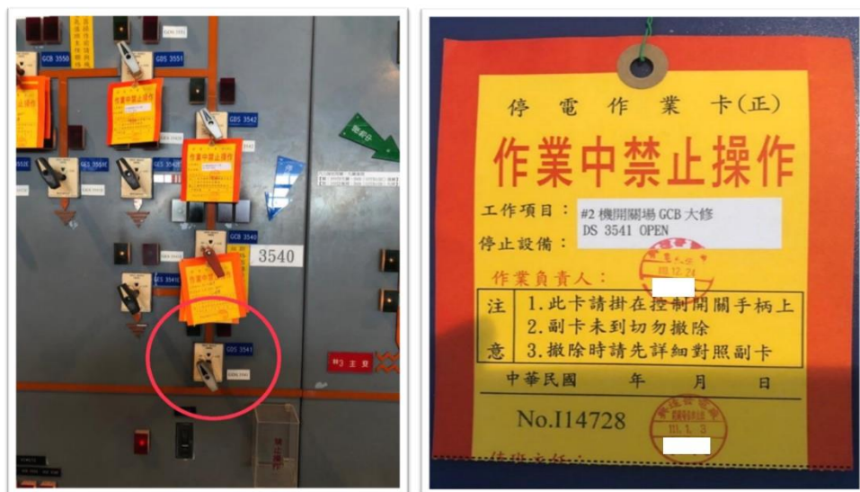
圖 2.3 現場操作盤面及開關設備掛鎖卡情形
