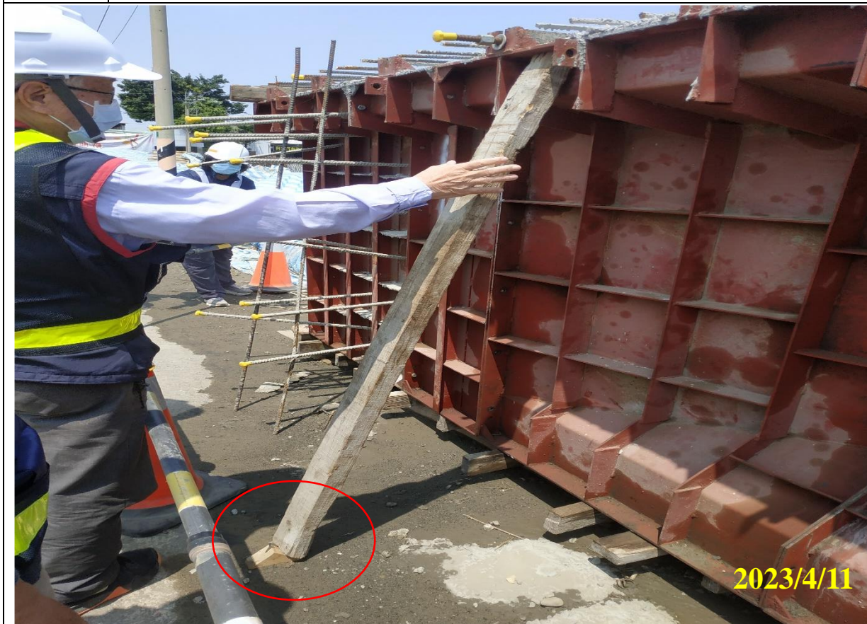
說明 | 預力樑斜撐未妥適固定。
