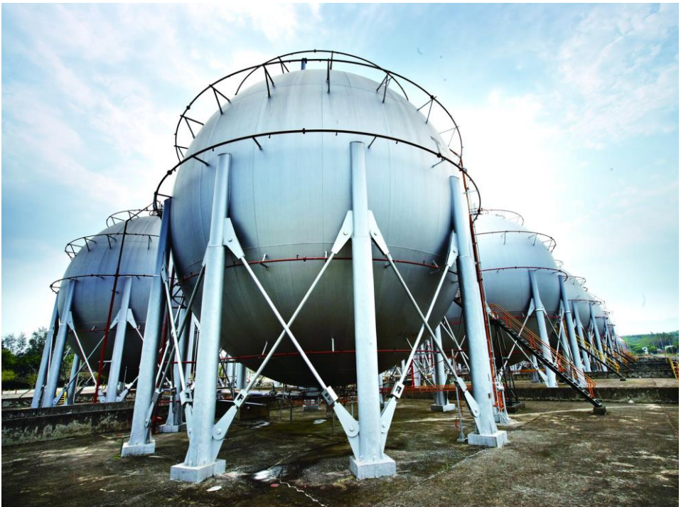
■ 中油公司-儲槽
