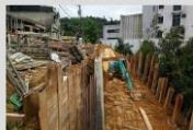
附件六-2承商雨天回填部分屬暫置作業，已請承商挖除背填區 審查通過 基隆市政府工務處
