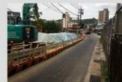
附件六-2承商雨天回填部分屬暫置作業，已請承商挖除背填區 審查通過 基隆市政府工務處
