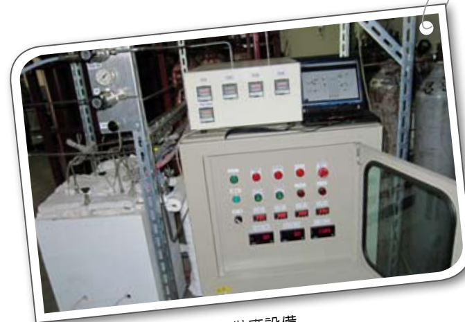
▲ 超高純度氫氣現場(純化)供應設備
