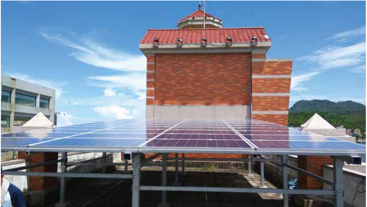
▲ 渡輪站太陽能岸電系統
