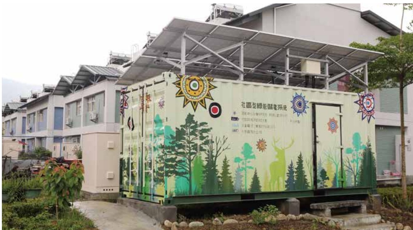
▲ 高雄日光小林村再生能源儲電系統(100kWh儲能貨櫃)
