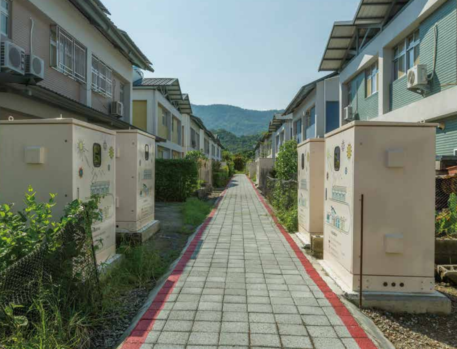
▲ 高雄日光小林村家戶型儲電系統（3kW太陽能光電板及6-10kWh電池模組）
