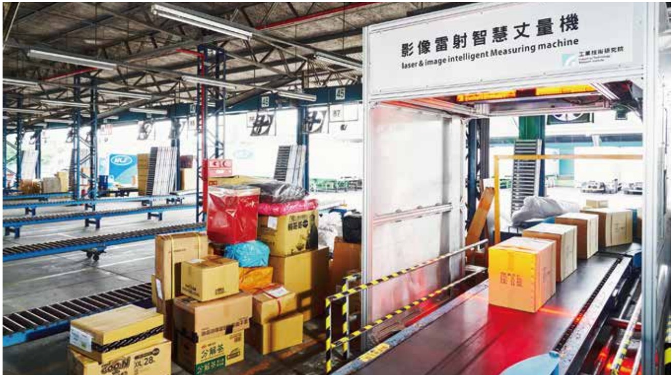
▲ 實現進存揀出貨智慧化之「自動材重辨識系統」
